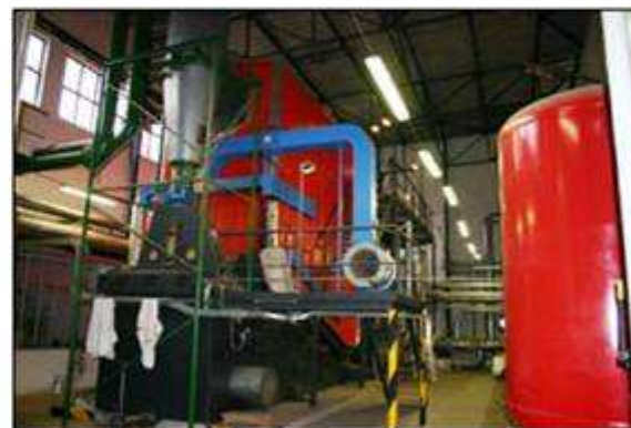
Pohled na instalovaný kotel.
