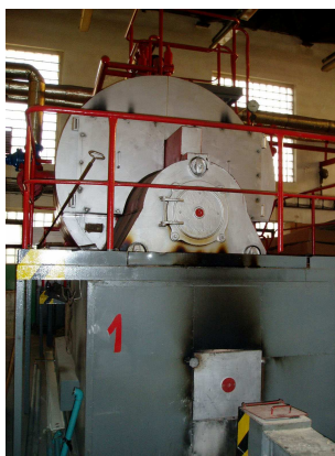
Obrázek 13.96 Pohled do kotelny
