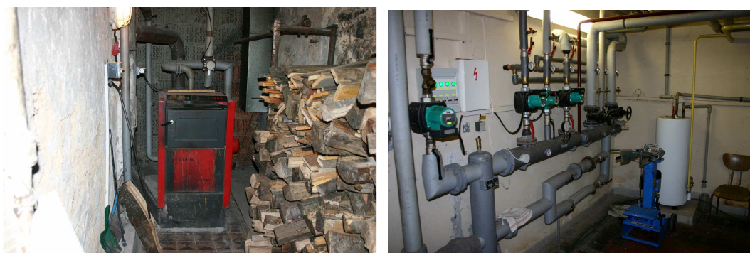
Obrázek 13.72 Zplyňovací kotel se zásobou dřeva.
