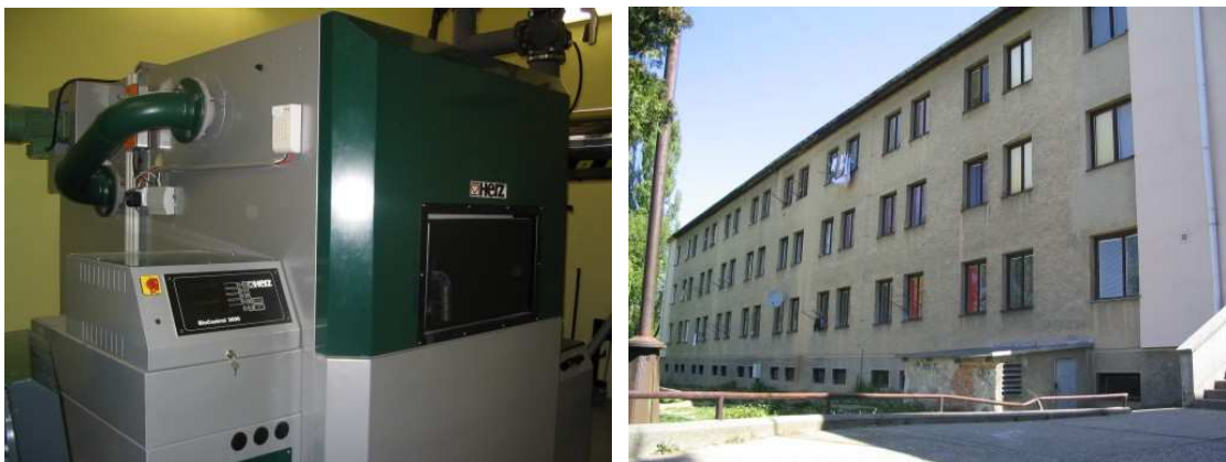
Obrázek 13.122 Kotel HERZ Firematic SR 250, část vytápěného objektu „360-ky“
