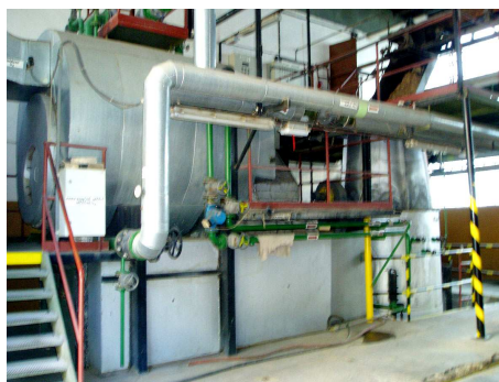
Obrázek 13.97 Celkový pohled na kotelnu
