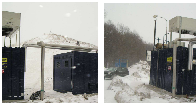
Obrázek 13.30 Pohled na jednotku
