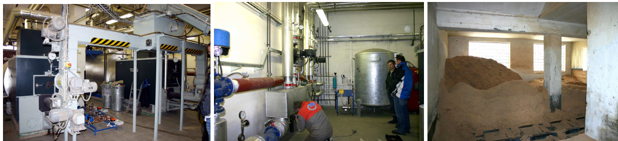
Obrázek 13.116 Celkový pohled do kotelny.
