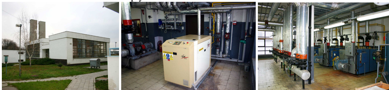
Obrázek 13.98 Kotelna využívající jako zdroj energie skládkový plyn.
