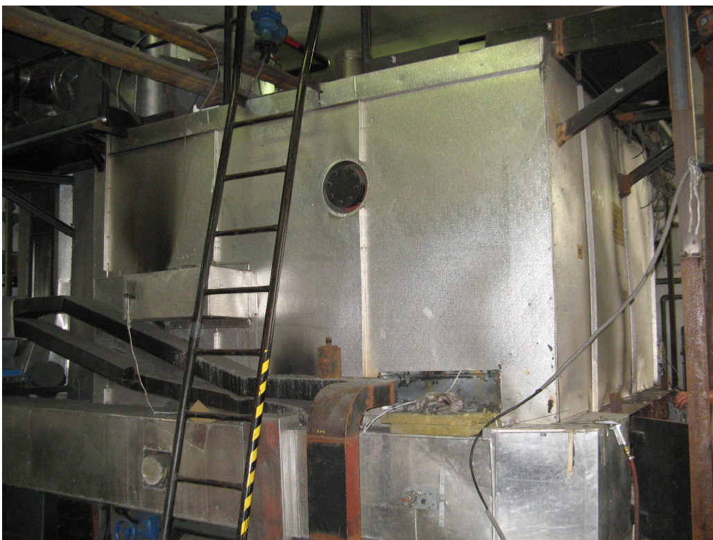
Obrázek 40 Kotel o výkonu 1 MW
