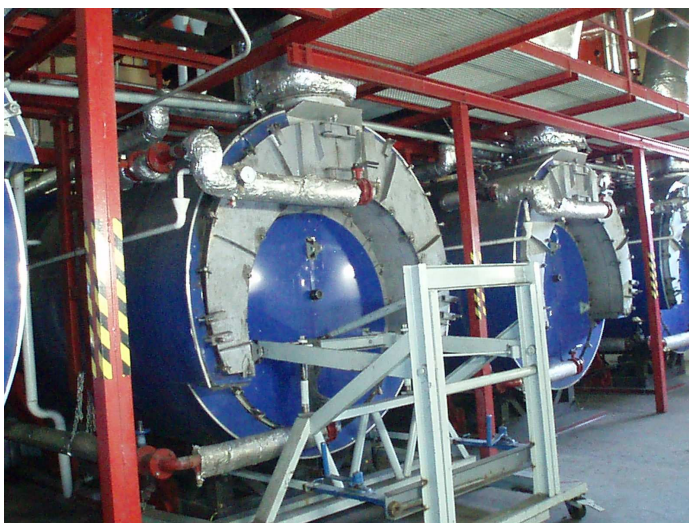
Obrázek 13 Kotelna – kotlové výměníky tepla
