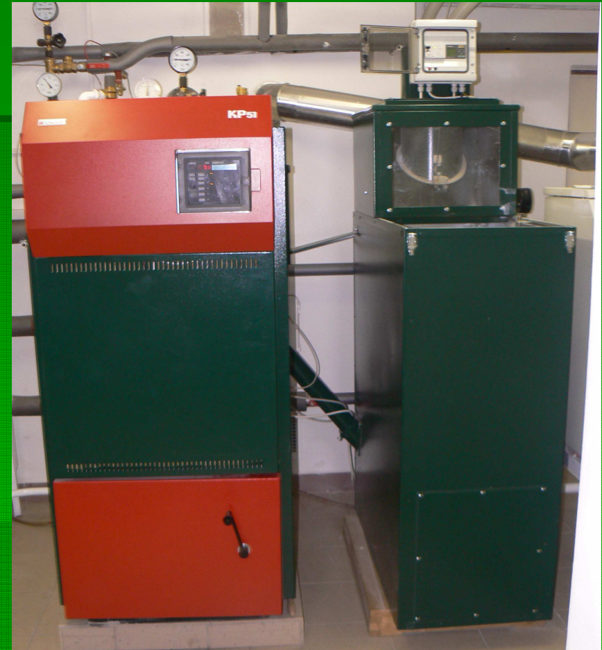
Obecní úřad Třanovice – kotelna na biomasu - 11/2008
