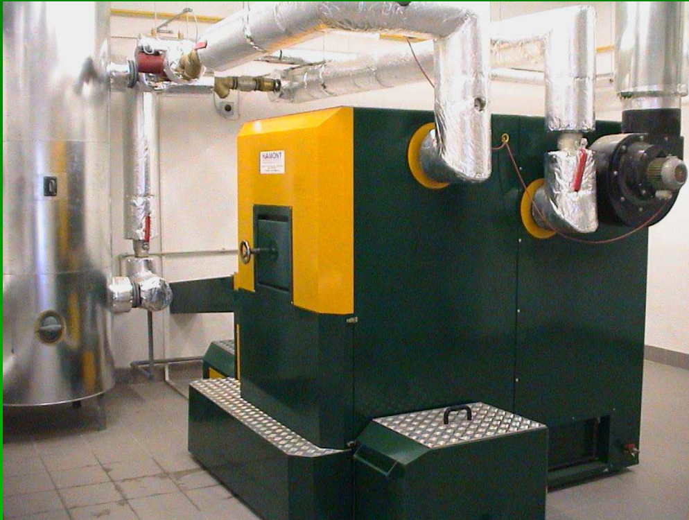
Podnikatelské centrum Kapplův Dvůr - kotelna na dřevní štěpku – 06/2003
