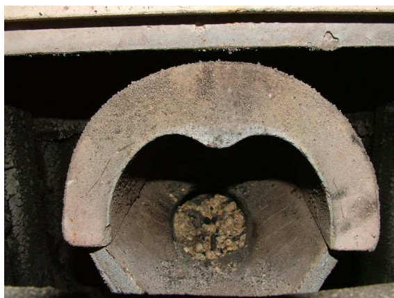
Obr. 1 Spalovací komora kotle Viadrus U22
