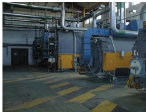
Obrázek 6.5 Kotelna na spalování štěpky
